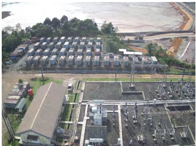
Gambar 5. Genset Agrekko yang sebelumnya digunakan sebagai sumber power di PT Agincourt Resources
