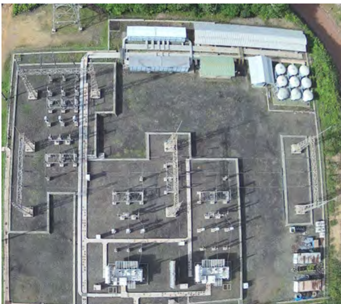
Gambar 6. StaticVAR Compensator yang di pasang di Gardu Induk Mining PT Agincourt Resources
