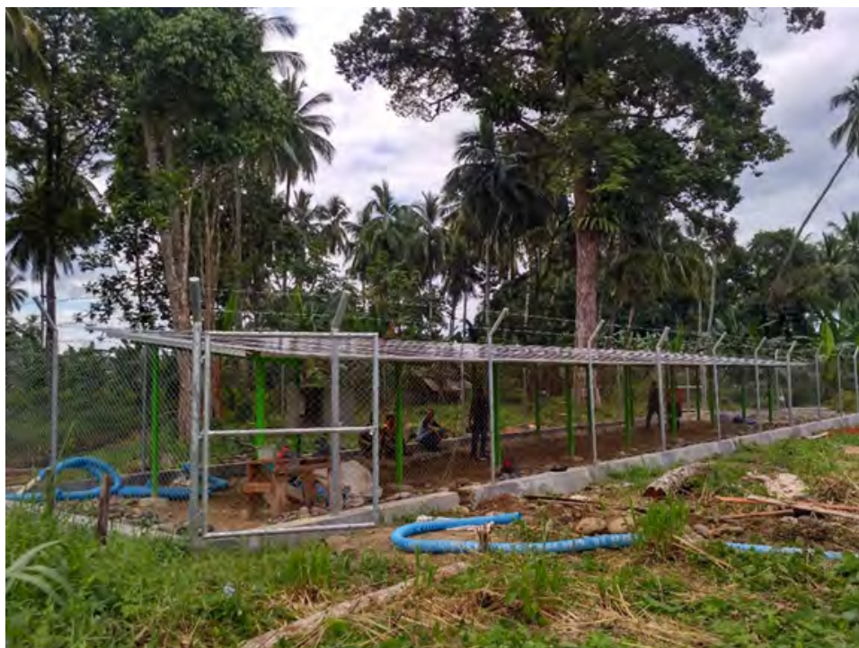
Gambar 8. Fasilitas Irigasi Pompa Hidram di Desa Pulo Godang
